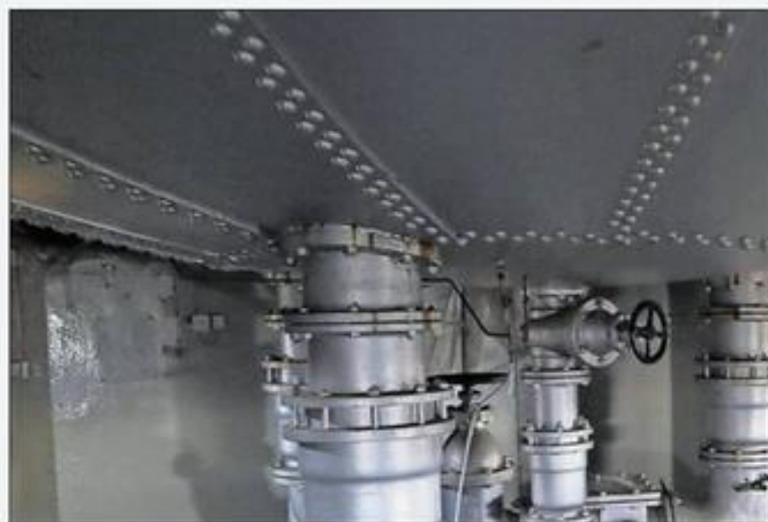
Der beeindruckende Wassertank innerhalb des 1897 in Betrieb genommenen Turmes kann bis zu 960 000 Liter Wasser fassen. Foto: Witthohn
