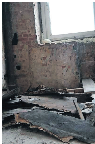
In den Gemäuern des Turms entstanden erhebliche Wasserschäden .
